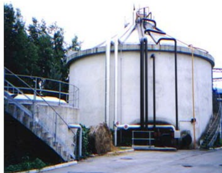
Figura 19: Digestore Anaerobico del WWTP di Treviso
