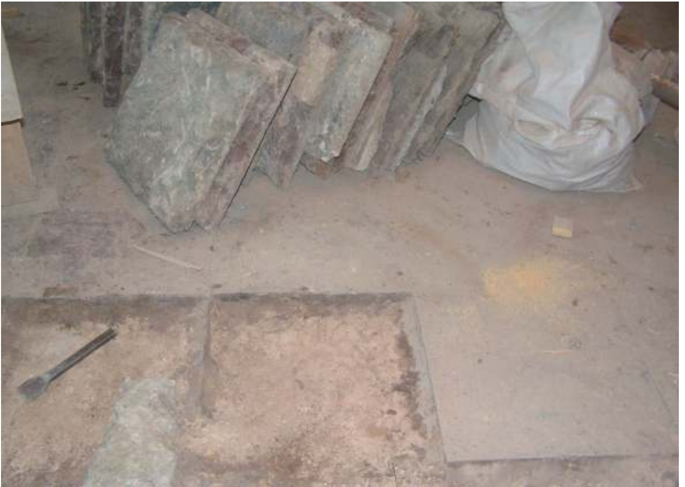
Fig. 35. Operazioni di rimozione delle lastre di pavimentazione originali durante i restauri del 2004, fotografia (Per gentile concessione di Andrej A. Mel'nikov, MAE RAN)
