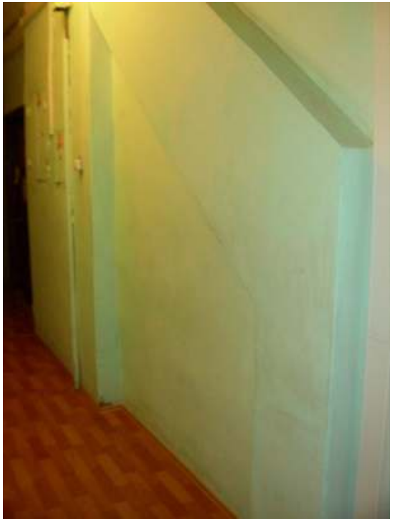
Fig. 18. Le canne fumarie per le stufe nel corridoio del secondo piano, fotografia (Guarneri 2008)
