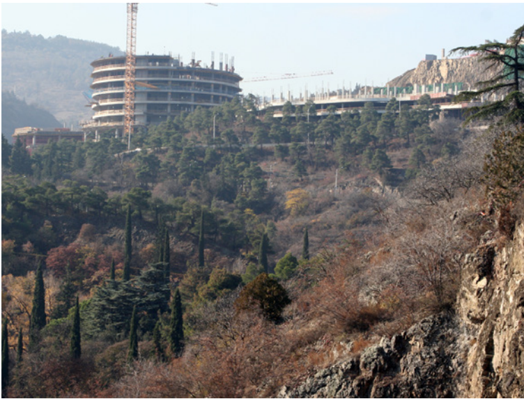
Figura 5 Il secondo edificio del progetto Panorama in corso di realizzazione nell'area collinare di Tbilisi. © Autore
