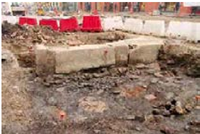
3. Bologna, scavi Crealis. Una delle strutture murarie ritrovate in Via Rizzoli. Un unico filare di grossi blocchi di selenite al di sopra di una fondazione in grandi pezzi di pietra e ciottoli
