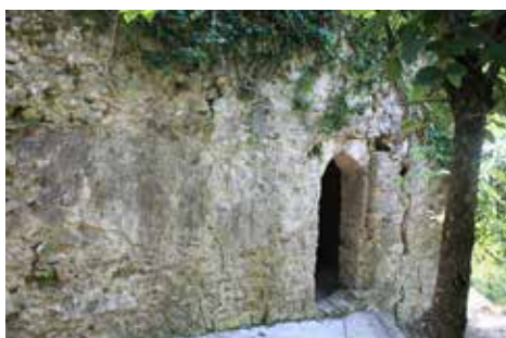
Figure 15-17. I principali fenomeni di degrado e di dissesto
