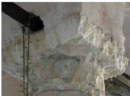
Figura 7. Un intervento condotto con materiale non compatibile ha prodotto un rapido degrado delle superfici
