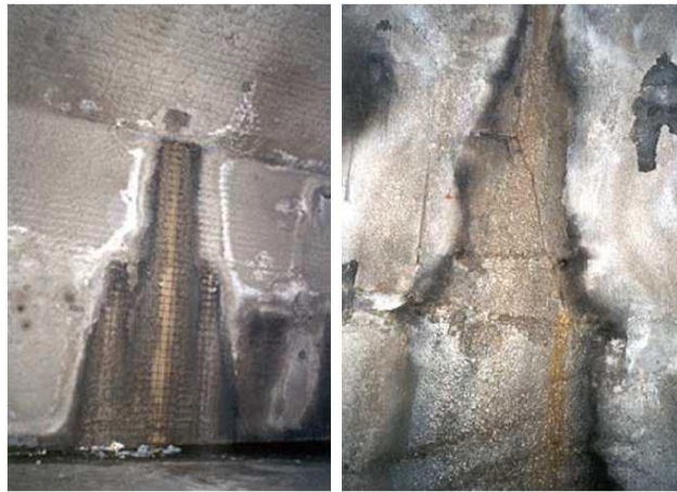
Fig. 1 – Esempio di attacco solfatico in una galleria
