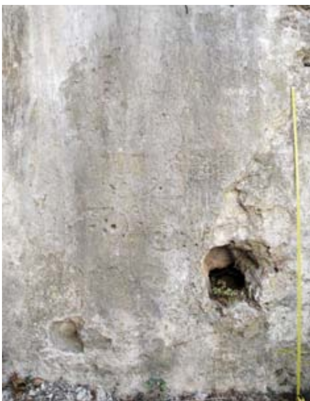
fig. 4.2 – I graffiti nell'intonaco di rivestimento dell'ambiente 153.
