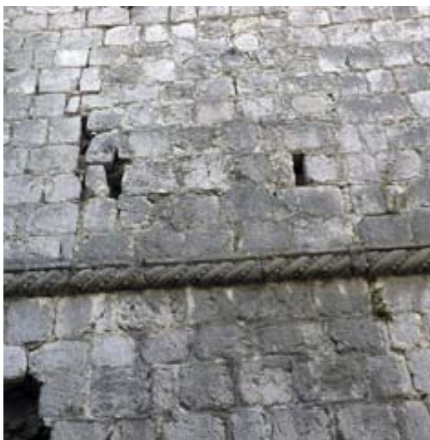
fig. 5.9 – Dettaglio del prospetto esterno nord del UTCF 136 a1, visibile la tamponatura USM 3050.
