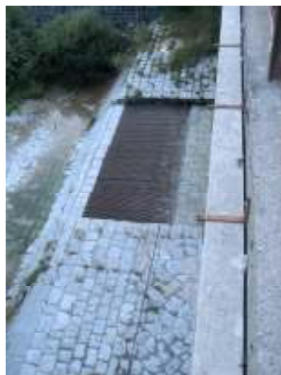
Fig. 4.134 - Opera di presa dell'acqua del torrente Grigno all'inizio del tratto GRI014.
