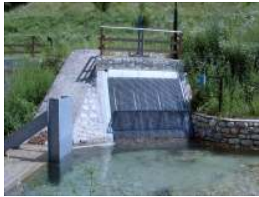
Fig. 4.52 - Opera di presa dell'acqua sul torrente Moggio all'inizio del tratto MOG011.
