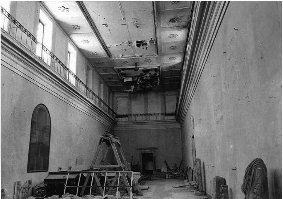
4-5. Ex convento di San Francesco alle Scale – Museo Nazionale e Pinacoteca civica, veduta delle sale espositive dopo i bombardamenti, Archivio fotografico della Soprintendenza per i Beni Ambientali e Architettonici delle Marche
