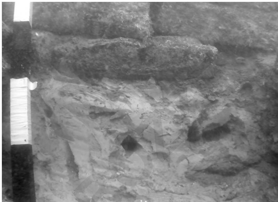
Fig. 3 - Sezione sottostante la cisterna-pozzo di Canale San Felice in cui si nota l'assenza di pali di fondazione.
