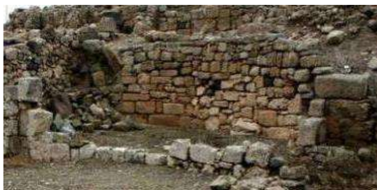
Fig. 143. Crollo dell'angolo sud-occidentale della parete di fondo dell'edificio n. 11 (foto M. Marano).
