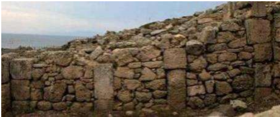
Fig. 223. Vista da Nord del lato settentrionale dell'USM 100 tra i due vani posti a occidente della corte dell'edificio n. IV (foto M. Marano).
