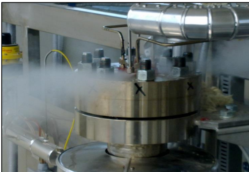
Fig. 36. Depressurizzazione del reattore SCWO per effetto della corrosione delle guarnizioni
