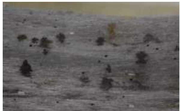
26 Figura, fori di sfarfallamento di piccoli coleotteri (diametro 2 mm) con deposito di segatura, piroga di Isella ID 34 (Lucchini 2019)
