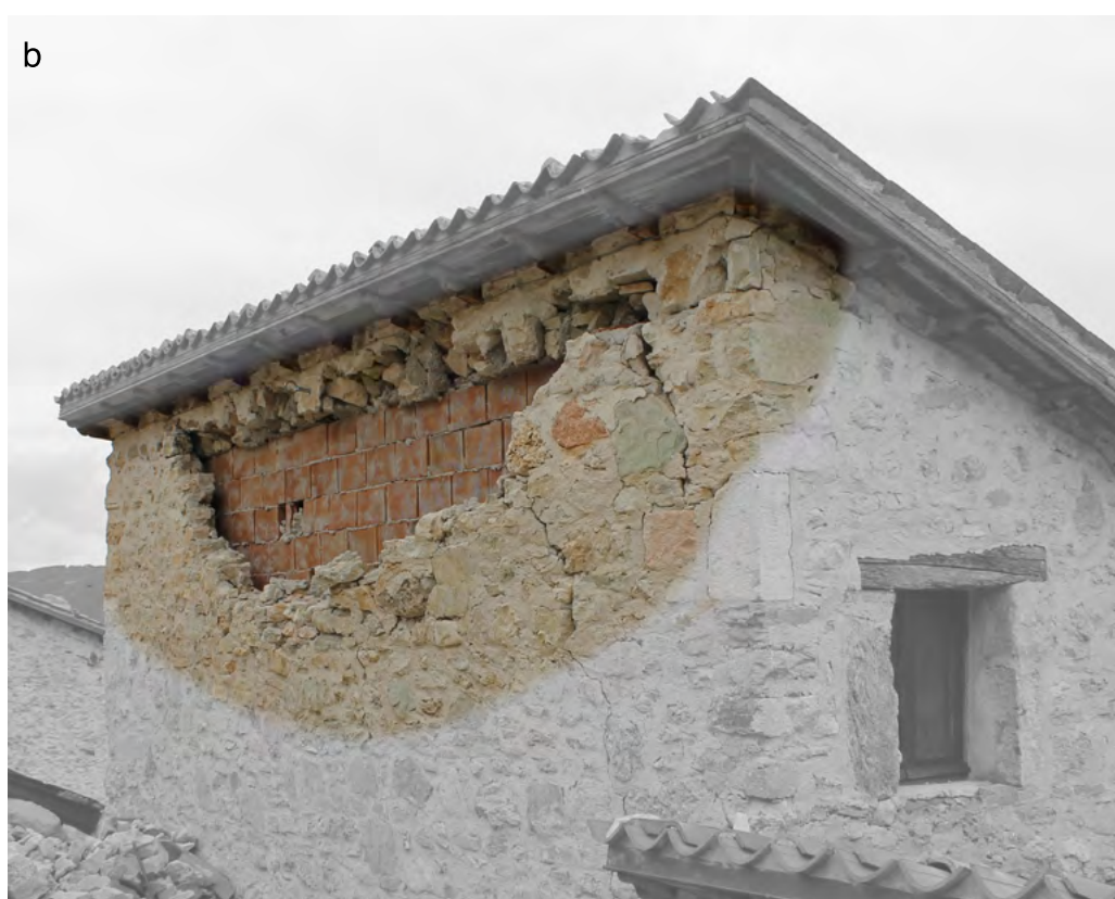
Fig. 4. Danno per interventi strutturali su murature non rinforzate: a) disgregazione e ribaltamento della parete per irrigidimento della copertura (Nocelleto di Castelsantangelo sul Nera, MC); b) scorrimento del solaio irrigidito (Campi Alto di Norcia) (foto ed elaborazioni autore).
