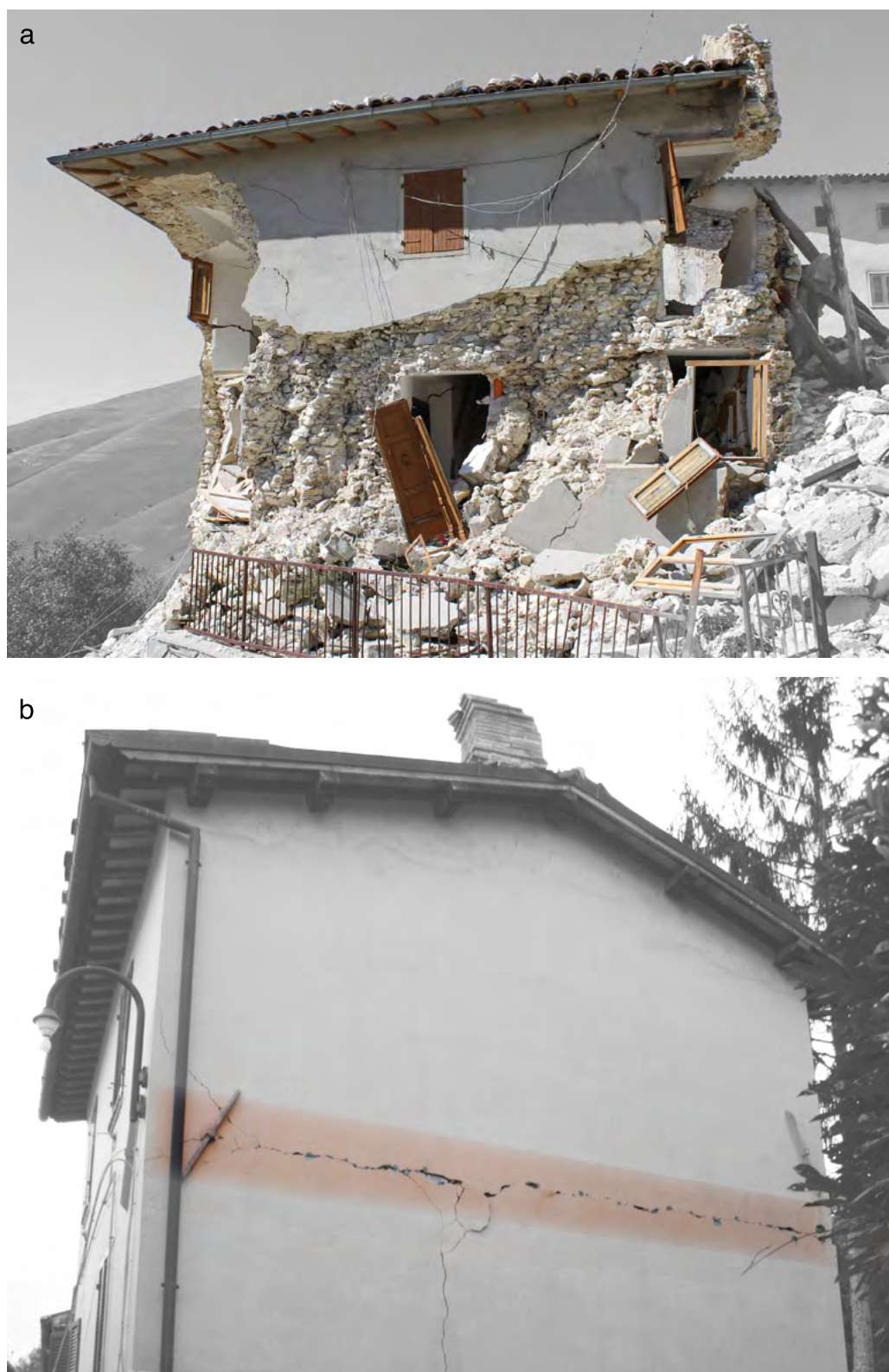
Fig. 3. Danno per interventi strutturali su murature non rinforzate: a) disagregazione e ribaltamento della parete per irrigidimento della copertura (Castelluccio di Norcia, PG) (da Saretta et al. 2020, fig. 1); b) scorrimento del solaio irrigidito (Pieve Torina, MC) (foto ed elaborazioni autore).
