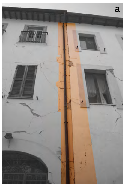
Fig. 2. Danno per trasformazioni della configurazione urbana: a) martellamento tra unità adiacenti e lesioni nel cantonale annegato sotto l'intonaco (Camerino, MC); b) ribaltamento di facciata non ammortata di unità di intasamento (Noceria di Castelsantangelo sul Nera, MC) (foto ed elaborazioni autore).
