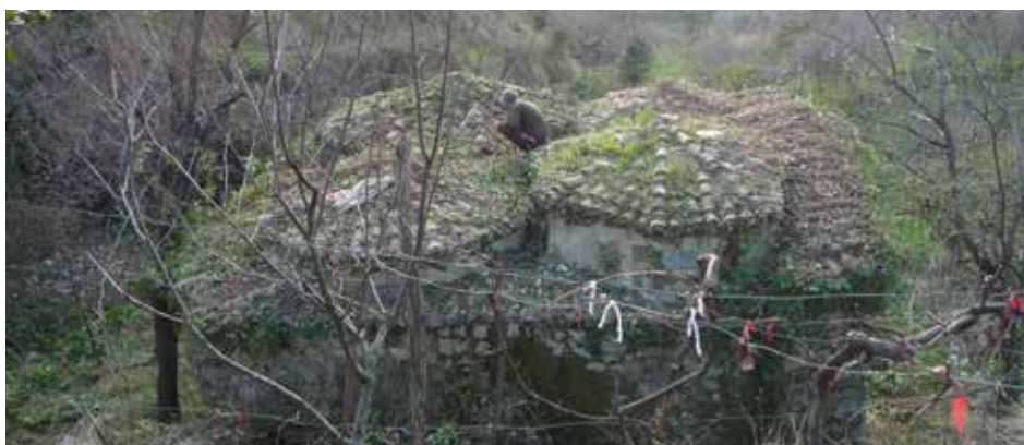
Figura 11. L'edificio dopo le operazioni di taglio della vegetazione infestante che lo nascondeva completamente
